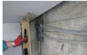
吹付ノズルと移動システム
